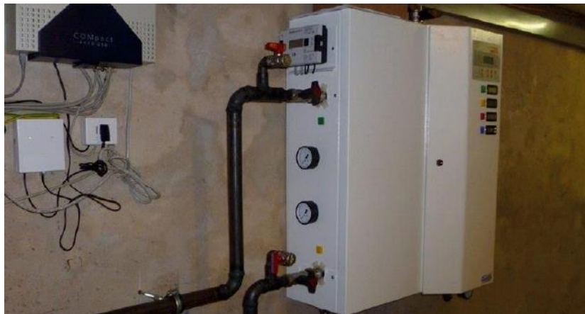
Abbildung 14: Typische Wärmeübergabestation im Keller montiert
